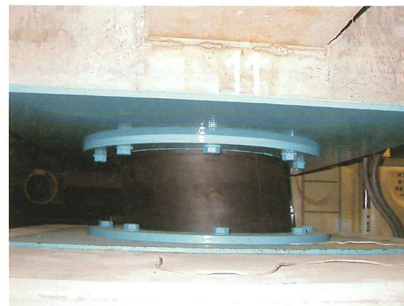
「水仙の家」の免震装置
