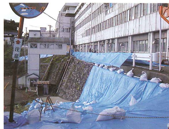
病院裏の崖崩壊
