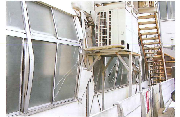
旧検査棟(被災当時)
