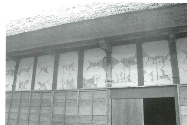
図3 重要文化財長谷川邸の被害
