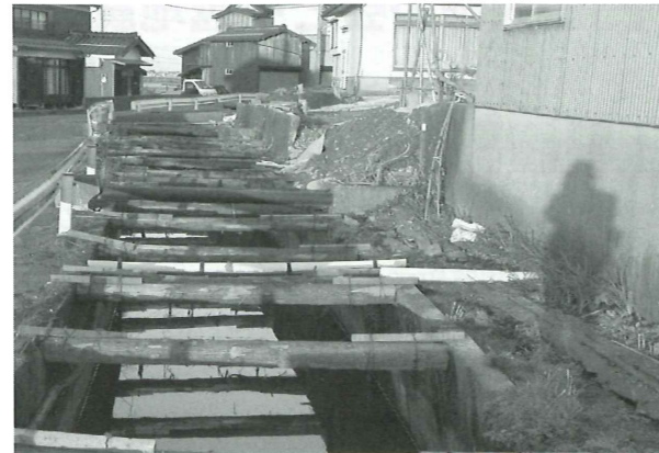
図1 朝日地区の被害
