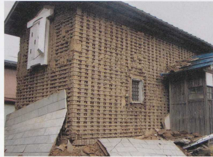
土蔵の壁落下
