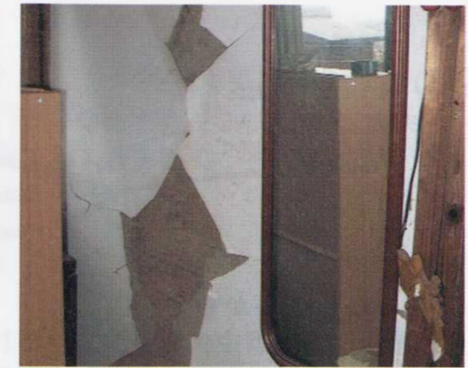
崩れ落ちた土壁
