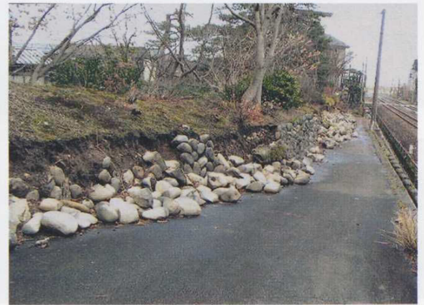
くずれた石積
