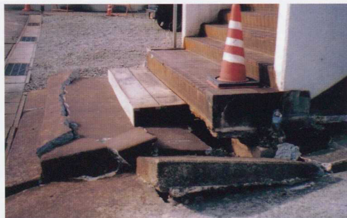
亀裂の入った階段
